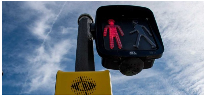
Figure 2. Feu sonore. On remarque la présence d'un haut parleur. Source : okeenea-tech.com
